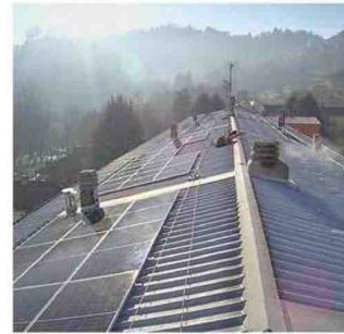
Pannelli solari posizionati sui tetti
